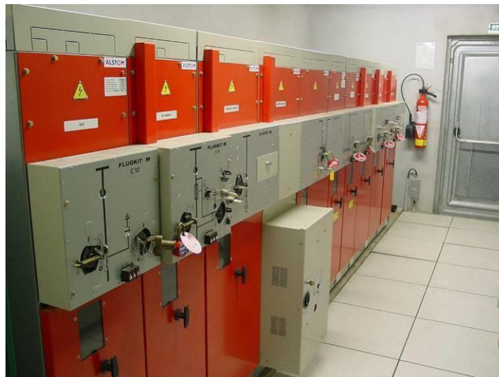
Intérieur d'un poste de livraison
